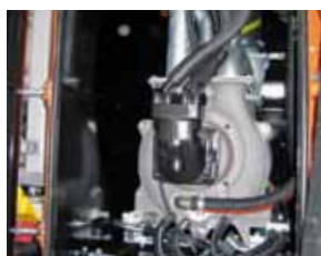
KWP v komore s čistou vodou
